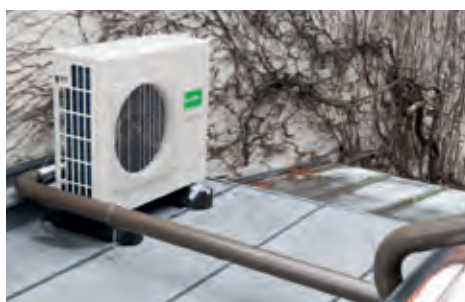
Außeneinheit mit geschützten Kältemittelleitungen
