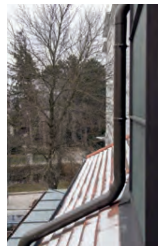
An das Gebäude angepasste, formschöne Verkleidung der Kältemittelleitungen
