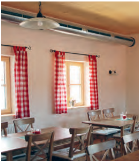
Zuluftrohr mit Rundrohrgitter
