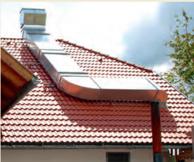
Steigleitung mit Einbindung in die Dachhaut
