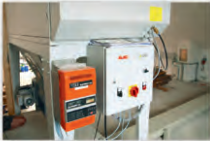
Steuerung mit Frequenzumformer
