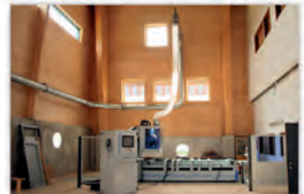
Absaugung an einer CNC-Maschine
