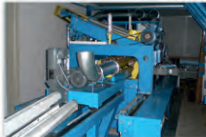
Absaugleitung an Maschine angepasst
