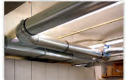
Rückluftleitung mit Lochblech
