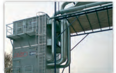
Profi Jet mit Abluftsträngen
