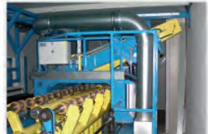
Absaugleitung an Maschine angepasst
