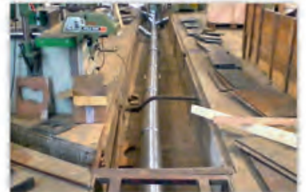
Abluftleitung in Bodenkanal
