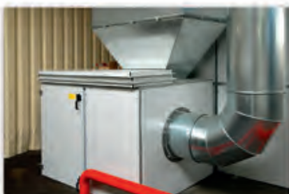
Abluftventilator mit Schallverkleidung
