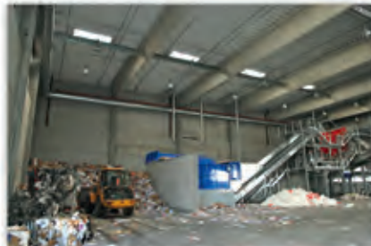
Rohrführung in Recyclinghalle
