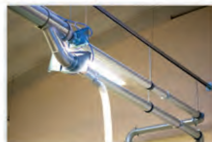
Spänerohre mit pneumatischem Schieber
