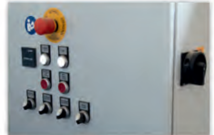
Schaltschrank der Späneabsaugung
