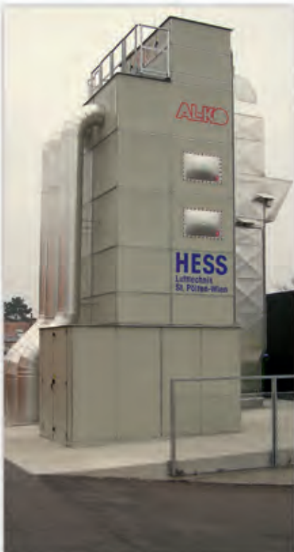
Profi Jet mit drei Rohrsträngen
